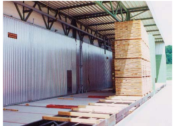
Bild 9-9 Einfahrseite eines Trockenkanals mit Querförderung. Die Stapel werden auf Gleiswagen bewegt, deren Spurräder quer montiert sind. Die Wagen klinken in Drahtseilzüge ein
