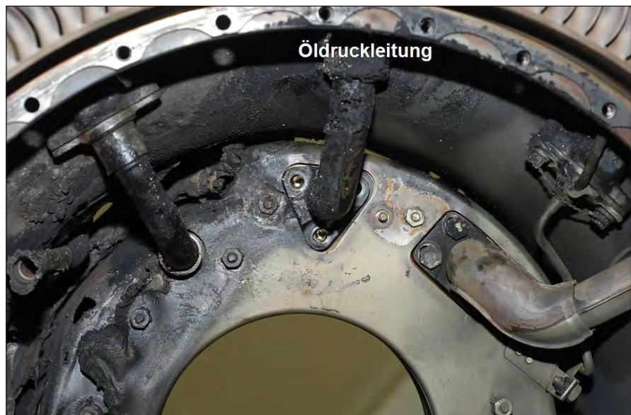
Abb 4: Öldruckleitung im eingebauten Zustand mit Verbrennungsrückständen.
