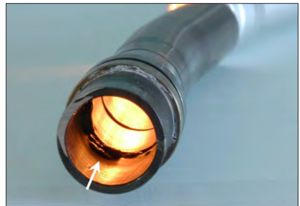
Abb. 10: Wurzelüberhöhung an der Innenseite des Schutzrohres
