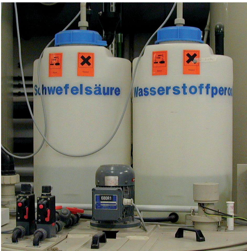
Bild 4.12 Dosierbehälter auf einer Behandlung, Werksbild OVIVO Deutschland GmbH Stuttgart
