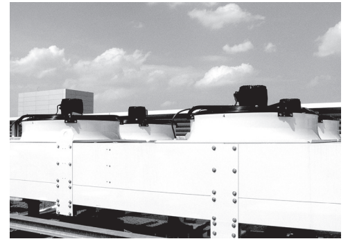
Bild 1.1: Rückkühlwerk einer Klimaanlage.
