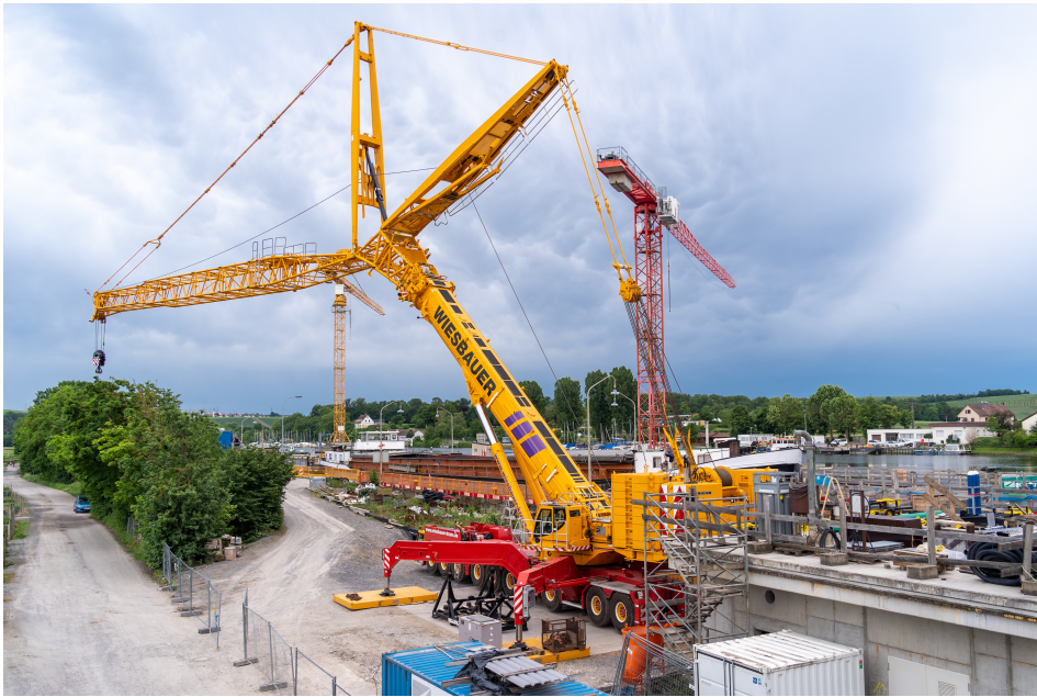
Bild 1.2 Ein LTM 1750 mit angebautem Gitterausleger (in diesem Fall einer sogenannten Wippe) zur Verlängerung der Reichweite des Krans. Natürlich ist die maximal mögliche Last bei Verwendung von solchen Verlängerungen erheblich geringer als ohne.
