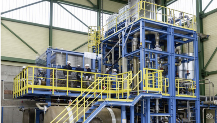
Bild 1.10 Elektrolytische Anlagen im Industriemassstab – hier die alkalische Elektrolyseanlage von thyssenkrupp Uhde Chlorine Engineering GmbH im Duisburger Stahlwerk von thyssenkrupp Steel – helfen bei der klimaneutralen Umstellung der europäischen Stahlproduktion © thyssenkrupp AG, Carbon2Chem®
