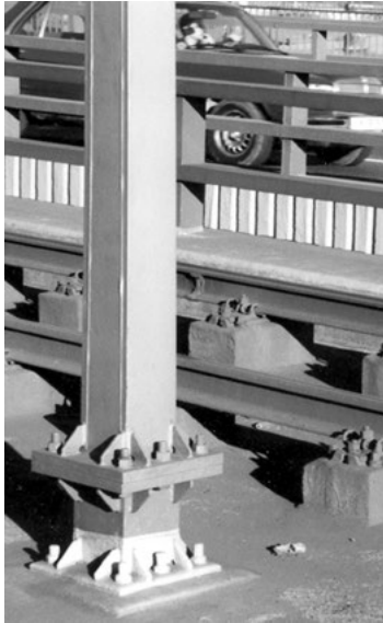
Bild 1.7 Fahrdradmast für Straßenbahn (Mastfuß)
